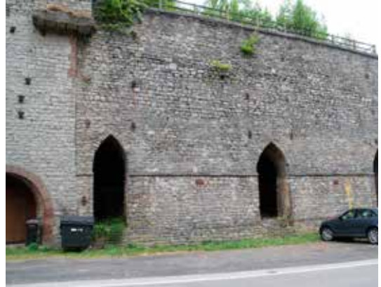
Fig. 2: Les fours à chaux le long de la route de Winenne, à l'arrêt depuis 1958. Juillet 2015 Photo F Van Troyen
